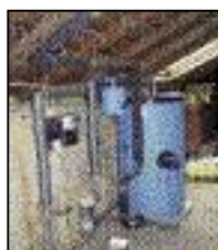
Le ballon solaire
