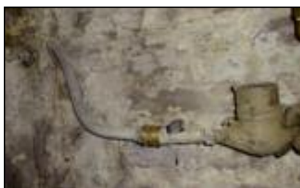
Installation en plomb
